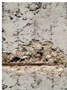
Figura 21 – Broca ou bicheira em elemento de concreto
