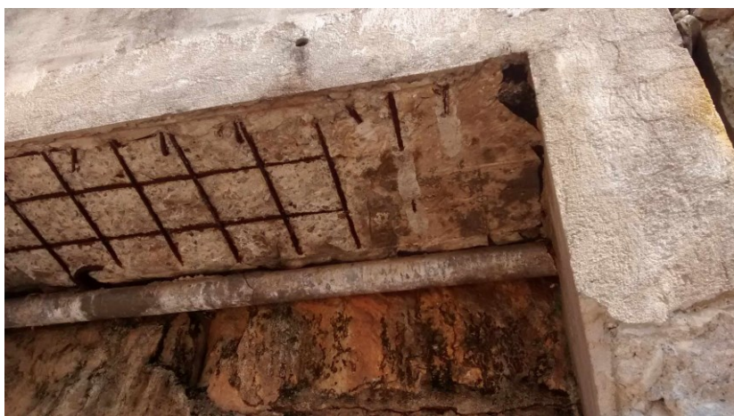
Figura 23 - Armaduras expostas sem cobrimento adequado sofrendo corrosão (Fonte: SILVA, 2018)
