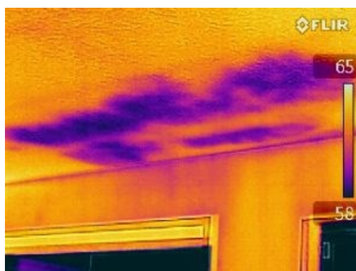
Figura 26 Exemplo de imagem de câmera termográfica de detecção de infiltrações (Fonte: SPMais Desentupidora e Caça Vazamentos, disponível em: https://cacavazamentosspmais.com.br/camera-termografica/?cn-reloaded=1 , acesso em 7 mai 2026)
