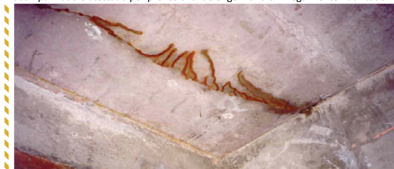
Figura 22 – Problemas na estrutura de concreto provocados por infiltrações
